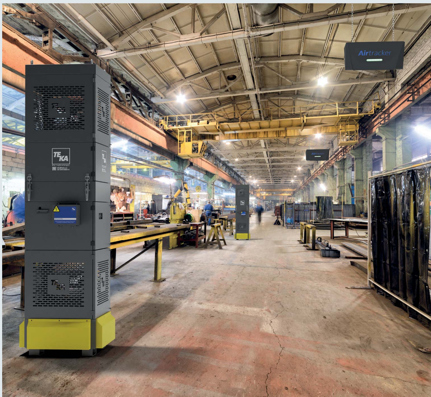
Exemple d'application CleanAirCubes avec Airtrackers
